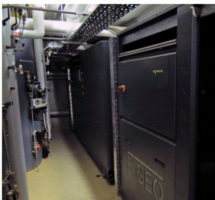
Foto 1 - Pompa di calore in sala tecnica
