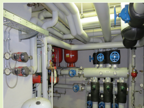
Foto 2 - Coibentazione sala tecnica
