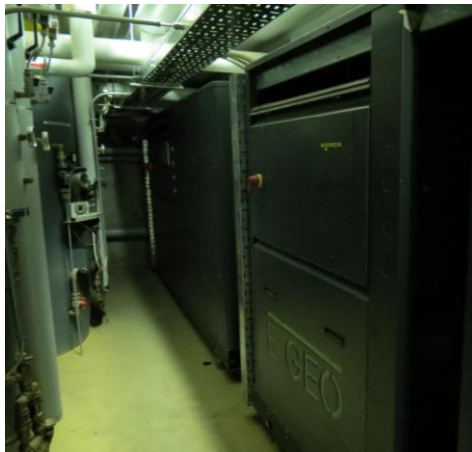
Foto 1: Pompa di Calore in Sala Tecnica
